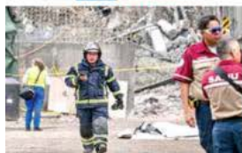
COLAPSA EDIFICIO EN DEMOLICIÓN
