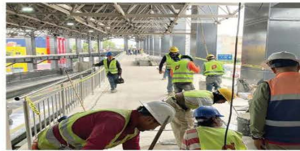
A MEDIAS. Oficialmente ayer inició operaciones la estación del Metro Chabacano de la L2, pero las obras continúan.
