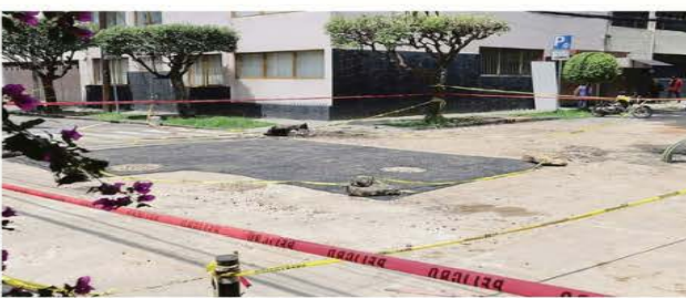
En la calle de Guty Cárdenas, esquina con Ricardo Castro, se registró uno de los más recientes socavones, que ya fue reparado.
