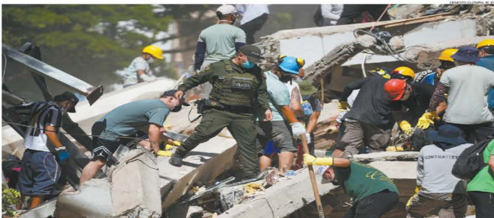
Voluntarios y rescatistas buscan sobrevivientes tras el colapso de un edificio en Cali.
